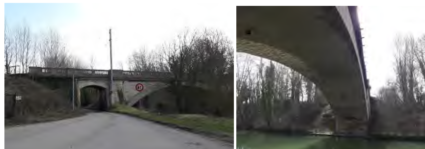
Figure 216 : Vues de l'ouvrage OA7 franchissant le canal de Meaux à Chalifert et le chemin des Aulnoyes (SOURCE : GROUPEMENT EGIS/ GAUTIER-CONQUET, 2018)
