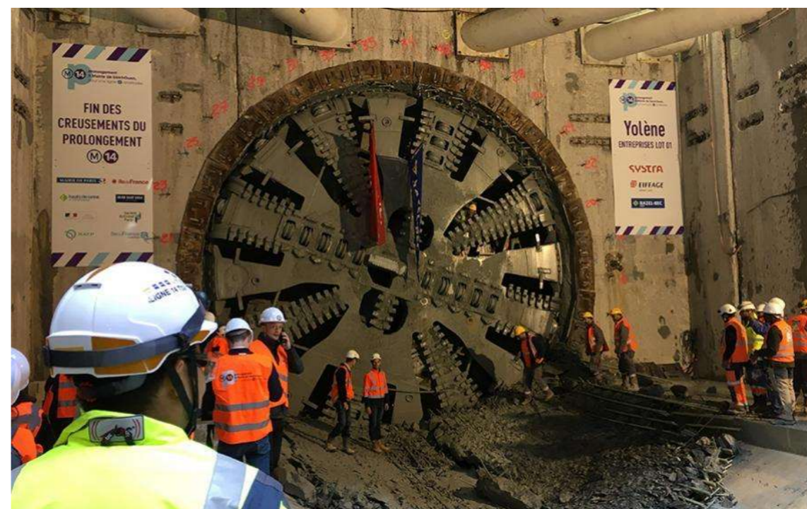
Figure 73 – Fin des creusements du second tunnelier Yolène entre Pont Cardinet et Clichy Saint-Ouen (Source : Eiffage)
