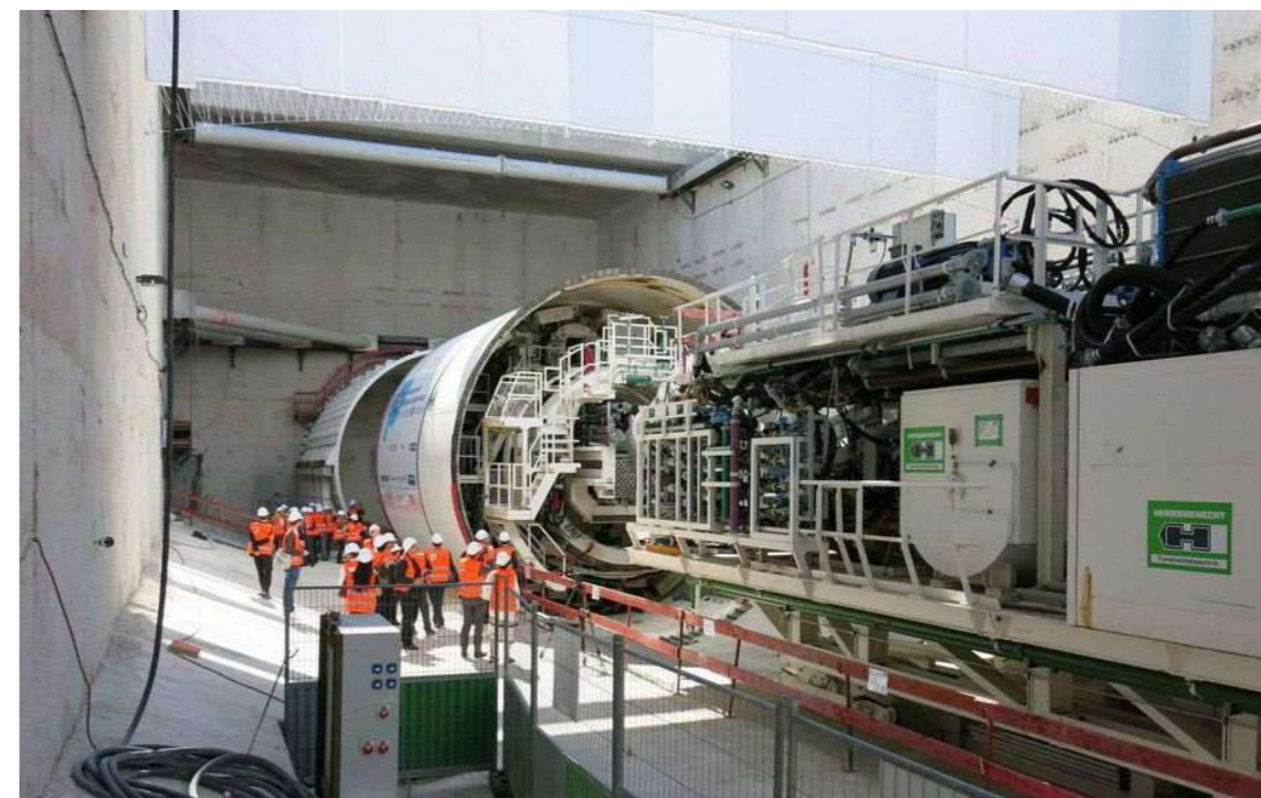
Figure 72 – Inauguration du tunnelier Magaly, qui a creusé la première partie du prolongement nord de la Ligne 14 entre Saint-Lazare et Mairie de Saint-Ouen (Source : Le Parisien)
