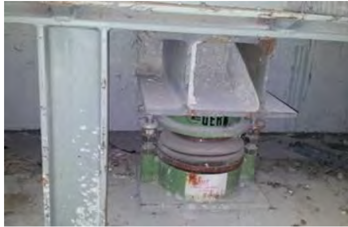
Figure 52 : Photographie d'un plot antivibratile implanté sur le poste de redressement « Dijon » (Ligne 14)
