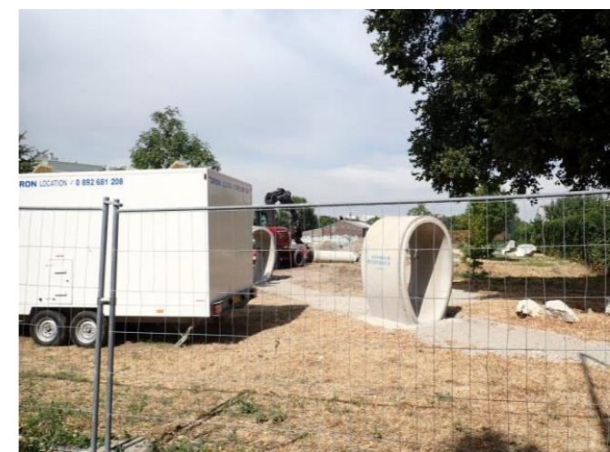
Figure 3 : Travaux en 2020 sur la pelouse située sur l'entité « Grands Pêchers » (source : EGIS)
