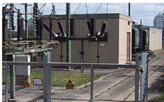
Figure 8 : Sous-station Source : Wikipedia
