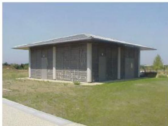
Figure 4 : Local à sous-station électrique
