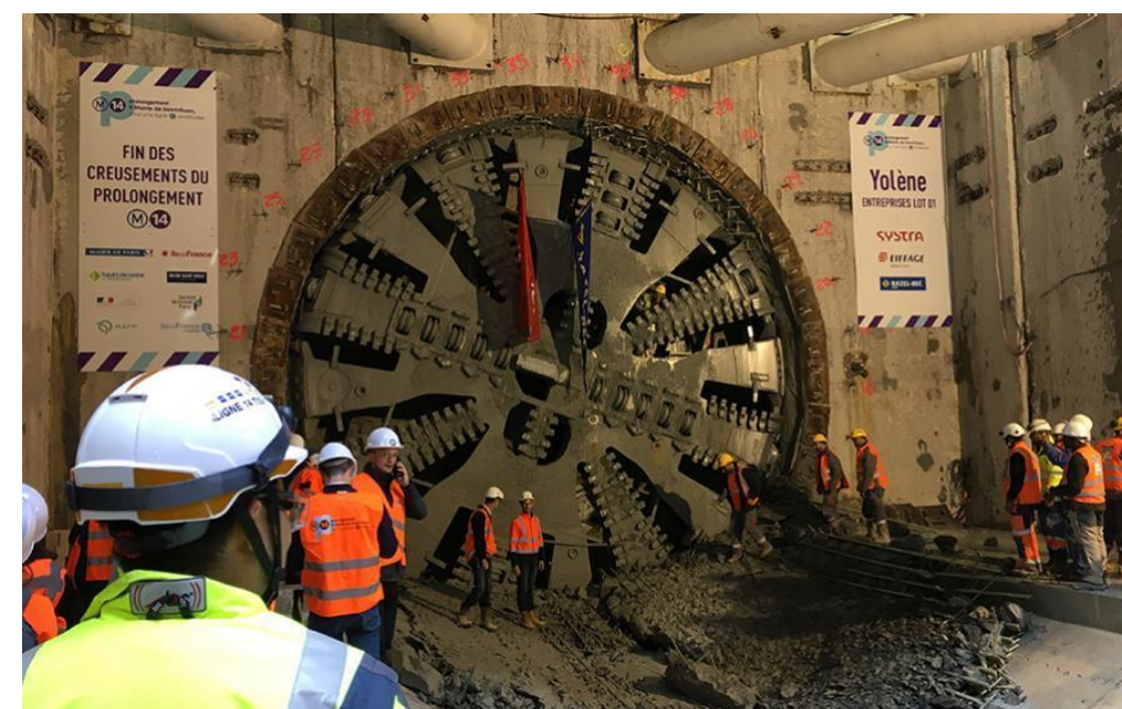
Figure 34 – Fin des creusements du second tunnelier Yolène entre Pont Cardinet et Clichy Saint-Ouen (Source : Eiffage)
