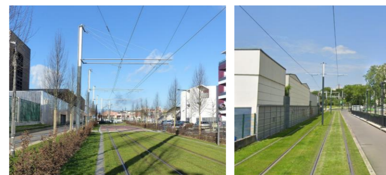
Figure 120 - Exemples de poteaux/mâts et supports LAC (Source : photo ligne de Tramway T8 existante)
