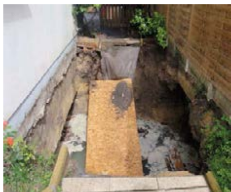
Figure 22 – Exemple d'un fontis d'environ 4 m de diamètre et plus de 5 m de profondeur observé à Sevran (93) en 2014 (Source : IGC)
