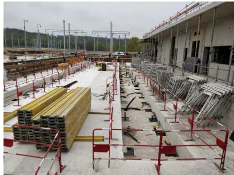
Construction des locaux de vie de l'atelier Construction des voies sur fosse
