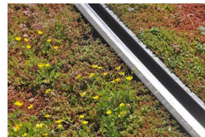
Figure 44 : Exemple de plantation de sedum sur plateforme tramway
