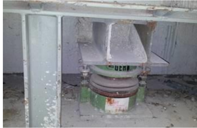
Figure 158 : Photographie d'un plot antivibratile implanté sur le poste de redressement « Dijon » (Ligne 14)
