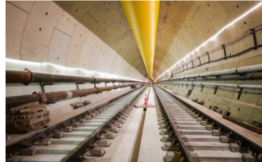
Ex: renouvellement voie et ballast avec un train usine & remplacement d'un pont centenaire à Massy – Régénération caténaïres ligne B et C
