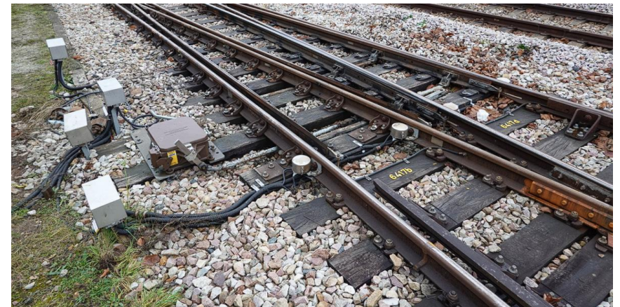
Moteurs d'aiguille remplacés
