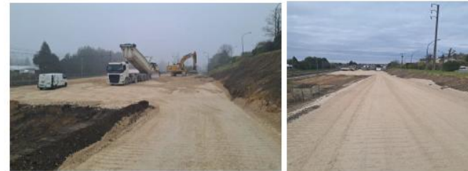
Sous-station de Souppes : 70%
