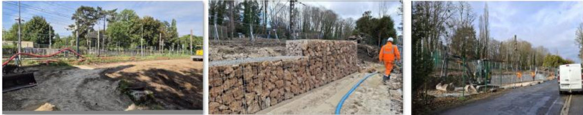
Sous-station Bois le Roi : finalisés
