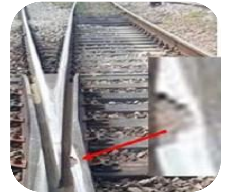
Coeur d'aiguillage endommagé la Garenne
