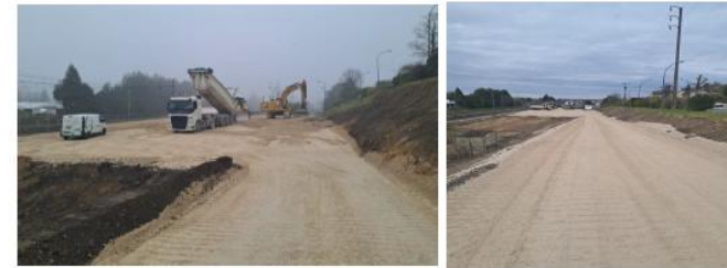
Sous-station de Souppes : 70%
