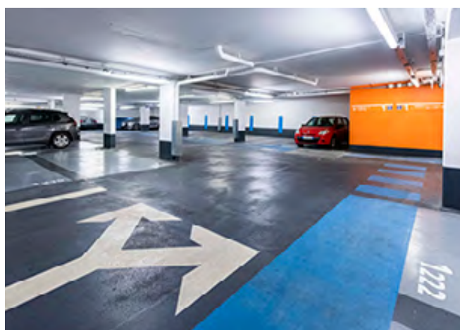
Éclairage Parking Relais de la gare de Bures-sur-Yvette (91)
