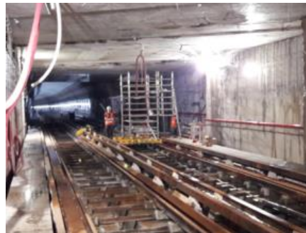
Dernier tronçon de voie posée dans l'ouvrage cadre sous gare RER C du 15/07 au 08/08 après coupure de la barrette de fondation gare SNCF
