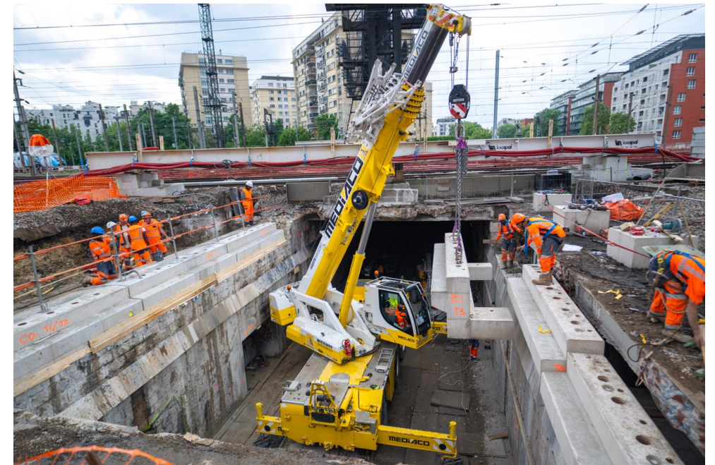
Pose des sommiers à l'aide d'une grue routière depuis le RER C
